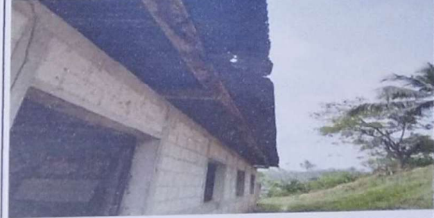
Foto 2: Se observa las costaneras y tigeras en deterioro total
