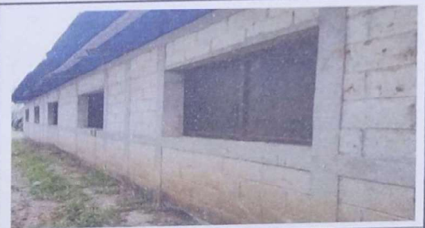
Foto 3: Se observa el deterioro de la estructura, sin pintura en las paredes.
