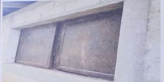
Foto 4: Se observa las ventanas de metal en mal estado, desprendimiento de pintura.
