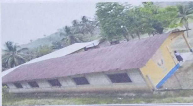
Foto 1: Se observa el deterioro total del techo del establecimiento, laminas bien oxidadas.
